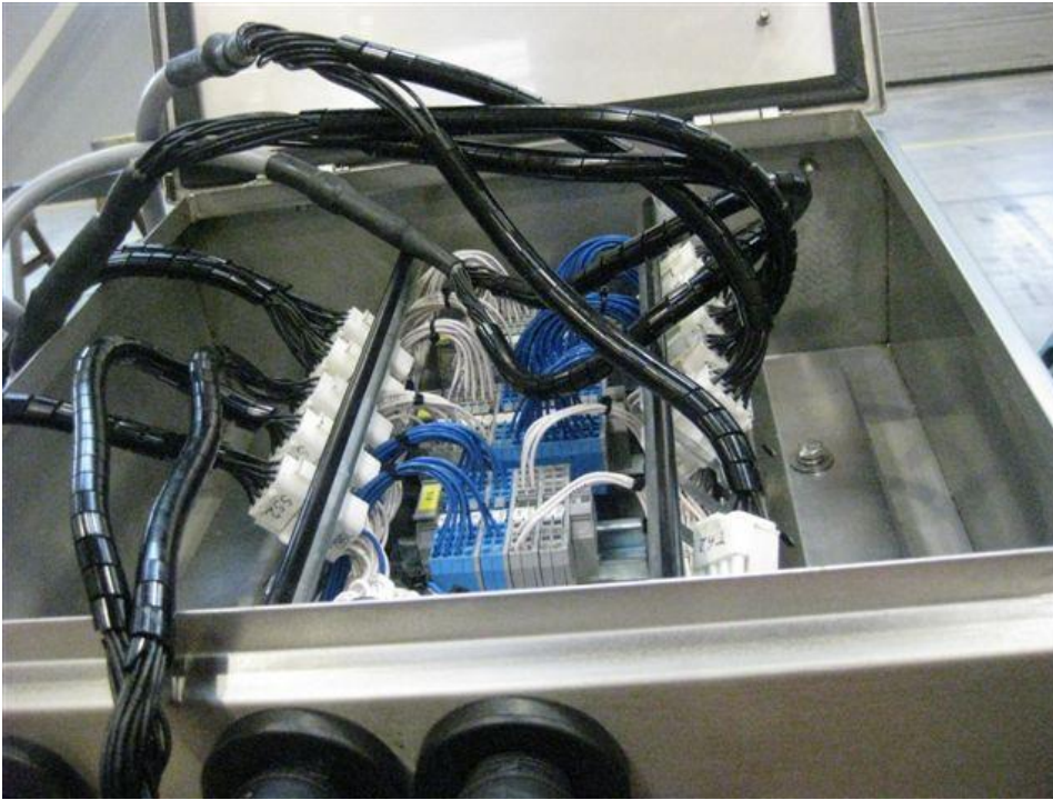
KUVA 4. Testilaitteen kytkentä X10 sähkökaappiin.
