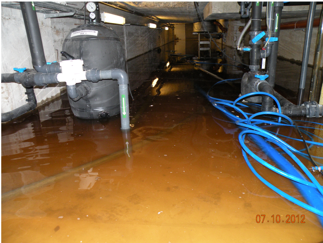
Kuva 3. Tulvan koettelema uimahallin ”konehuone”.
