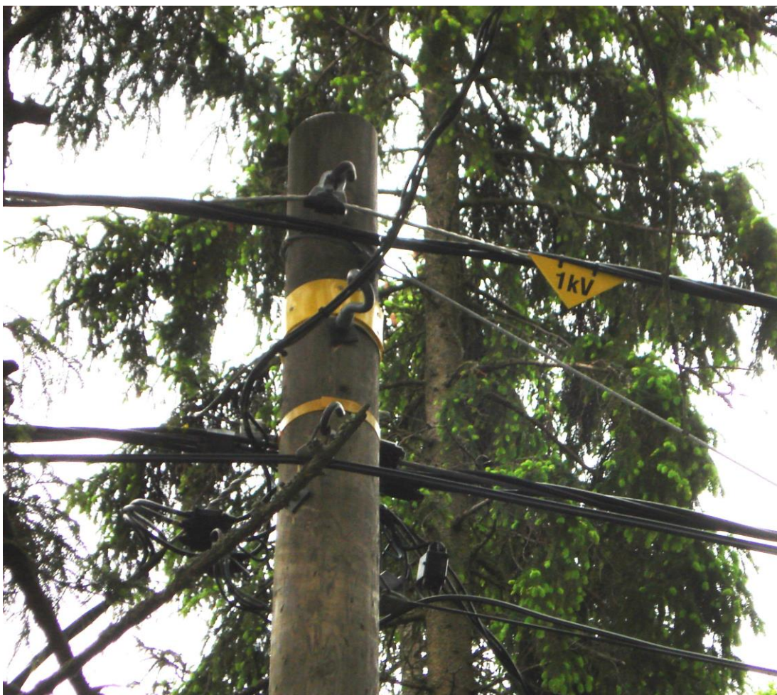
Kuva 14. Rauman Energian verkon 1 kV pylväs- ja johtomerkinnot
