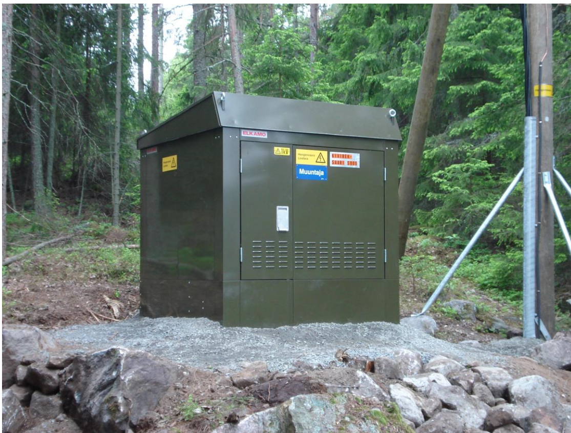
Kuva 15. Rauman Energian 1 kV puistomuuntamon merkinnät
