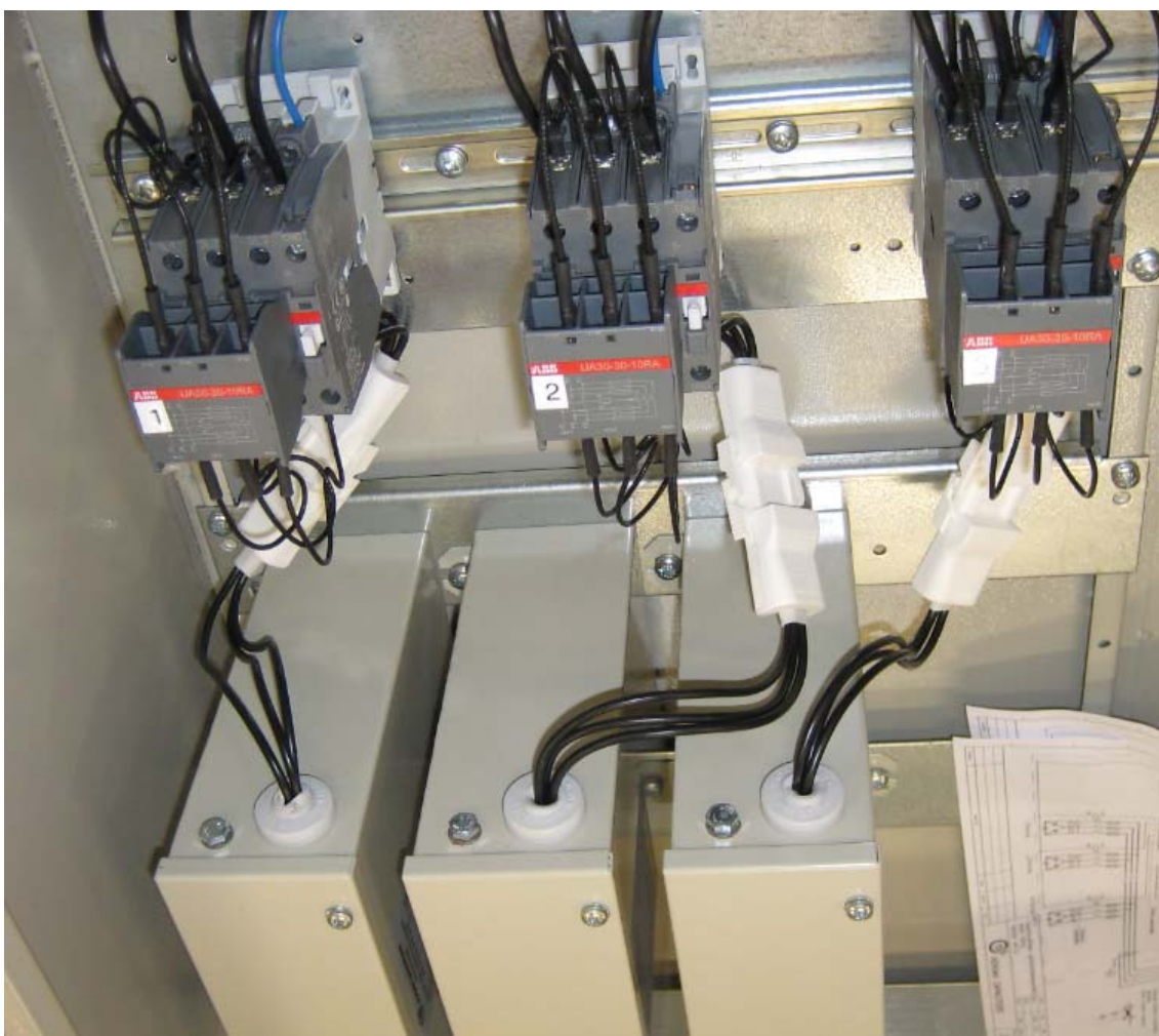
Kuva 8. Kytkinlaitteiden ja kondensaattoriportaiden välinen kaapelointi.
