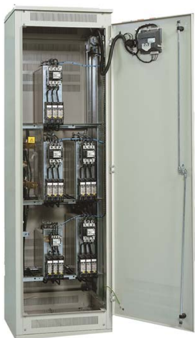
Kuva 6. Esimerkkikuva automatiikkaparistosta. (Nokian Capacitors luentomateriaalit)
