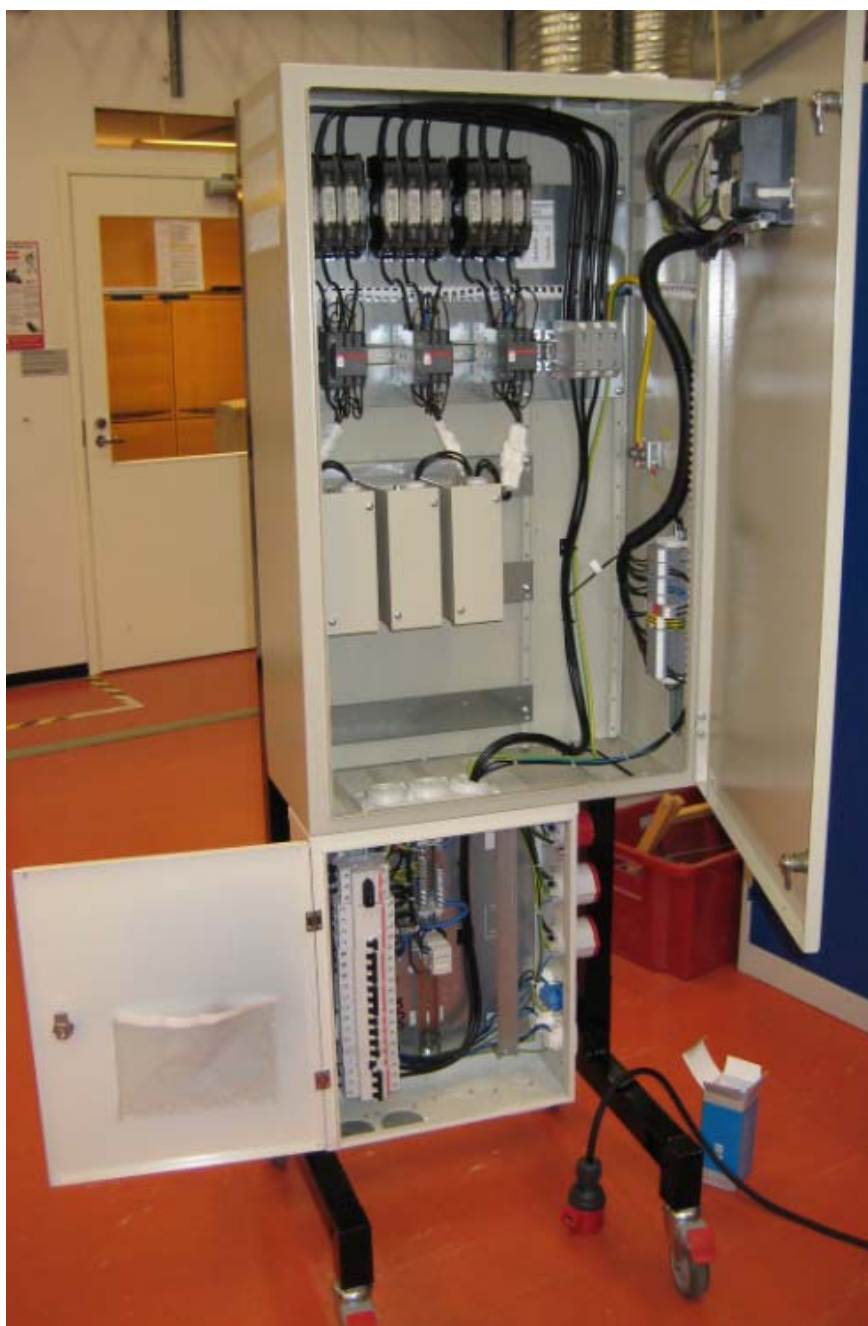
Kuva 8. Kompensointiparisto ja sähkökeskus sijoitettuina telineeseen.
