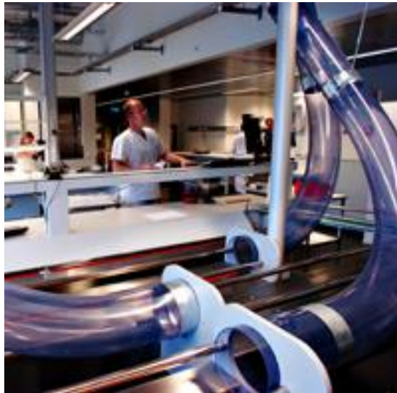
Kuva 5. Putkipostijärjestelmä (Swisslog transponet pneumatic tube system)
