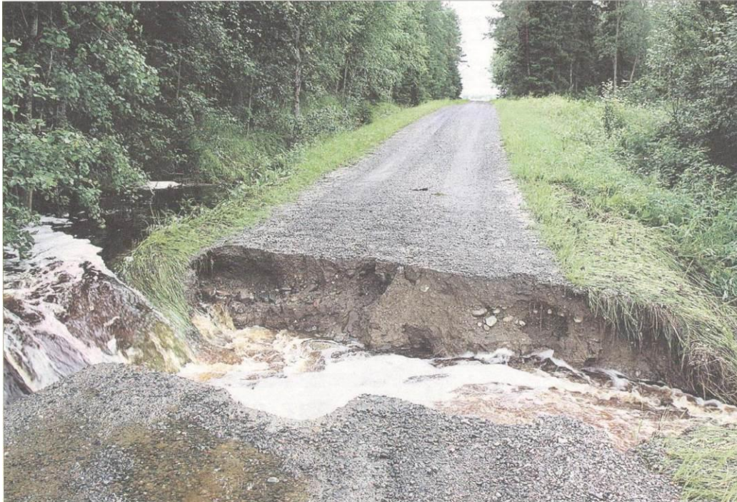
Så här ser en del av Långängsvägen ut i Korsbäck just nu. Dänet av vattenmassorna som forsar genom den gamla väggrunden är enormt. I skrivande stund var åtminstone tre olika vägar i byn totalt oframkomliga med bil. Till vissa delar av byn kan man inte över huvud taget ta sig med fordon. Foto Anders Eklund
