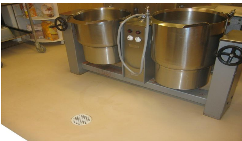
Kuva 7. Lattiamateriaalina on muovimatto sekä kippipatojen edessä on pieni lattiakaivo
