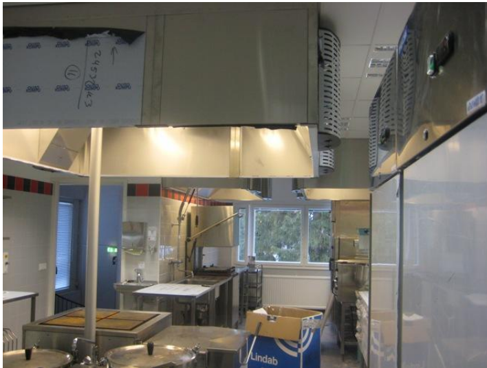
Kuva 11. Uudet ilmanvaihtokoneen höyrykuvut ovat massiivisia.
