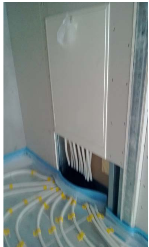
Kuva 20 Seinään upotettava jakotukkikaappi. Kuva: Jere Viljanen
