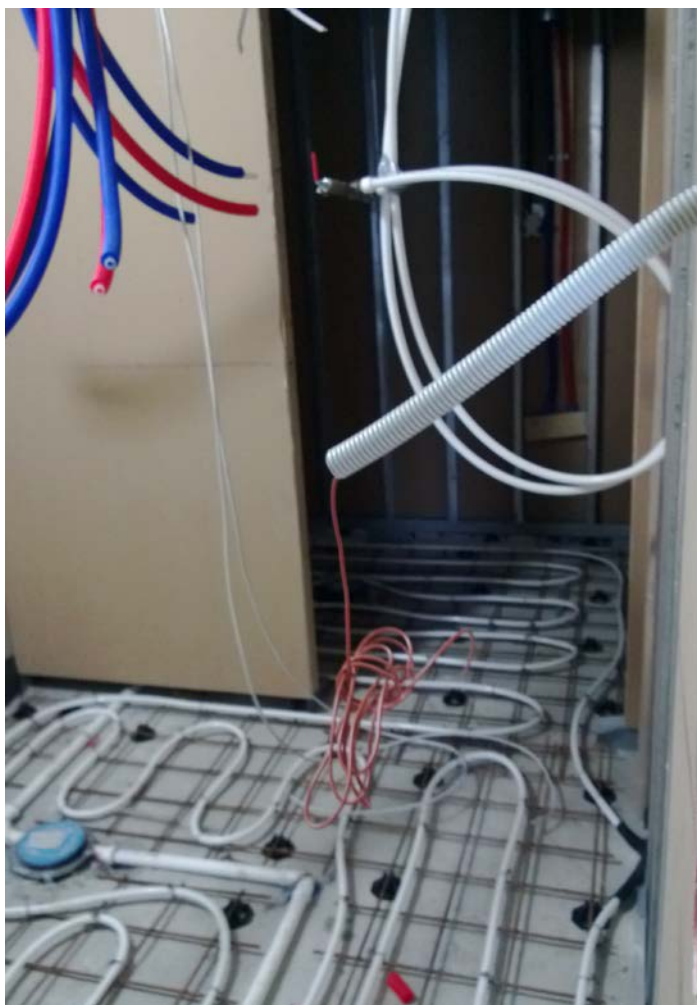
Kuva 25 Kylpyhuoneen putkitus omalla jakotukilla. Lämmityspotket nousevat seinän sisään oikealla alhaalla. Kylpyhuoneen oma jakotukki sijaitsee alakatossa. Kuva: Jere Viljanen
