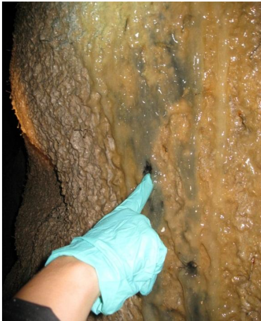
Kuva 3. Biofilmiä Kehäradan tunnelissa (Pöyry Finland Oy)
