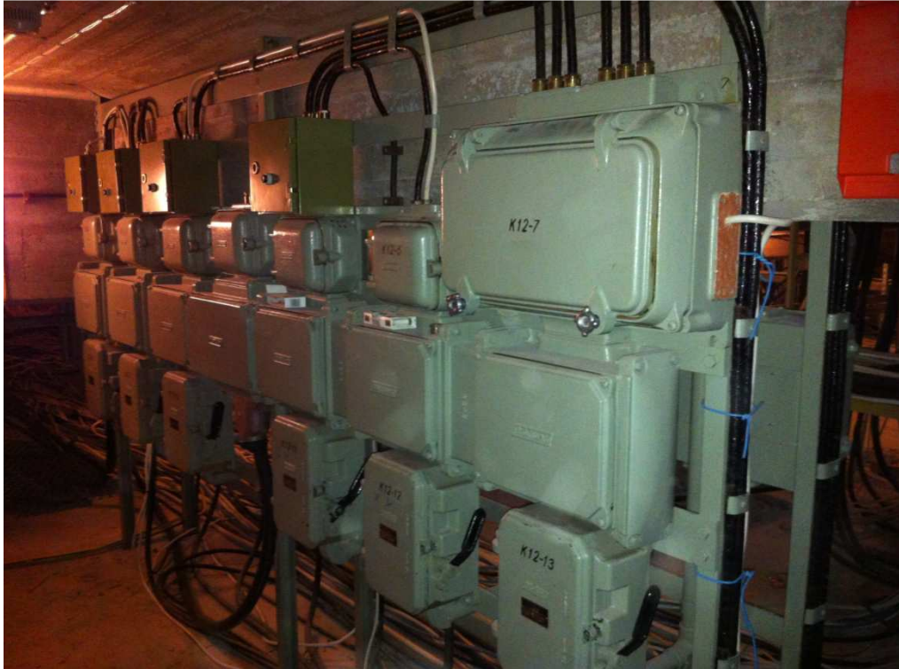
Kuva 2. Vanhan lämmityskeskuksen sulakepuoli
