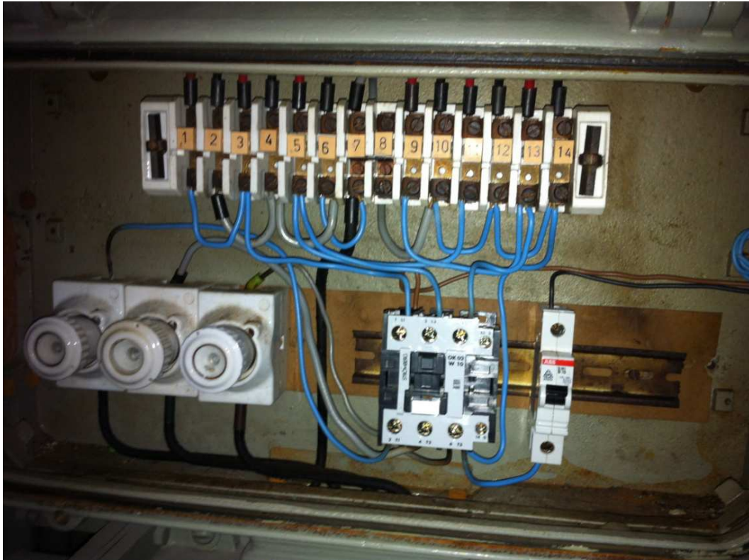
Kuva 4. Lattialämmityksen ohjaus ja riviliittimet
