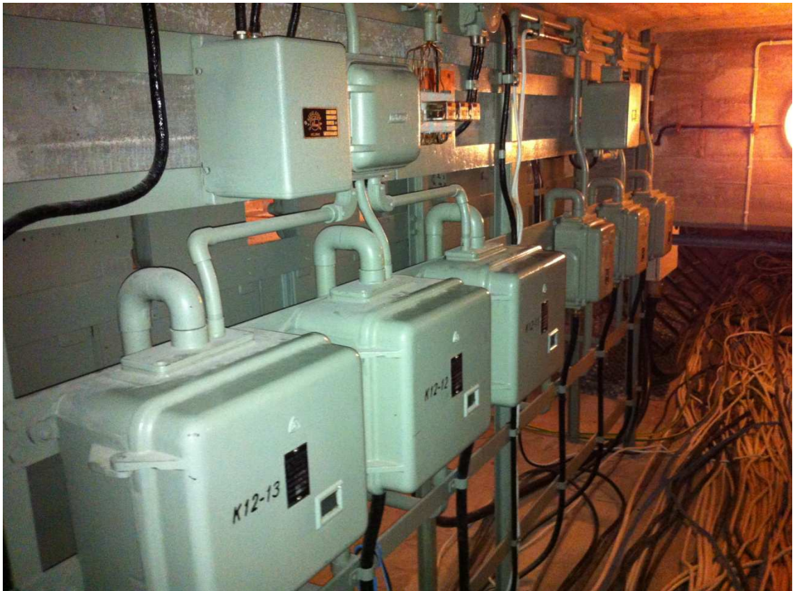
Kuva 3. Vanhan lämmityskeskuksen ohjauspuoli
