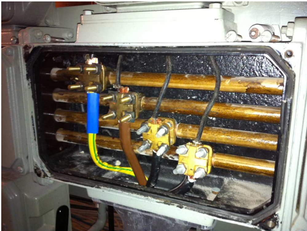
Kuva 1. Vanhan lämmityskeskuksen kiskosto ja syöttökaapelin liittimet
