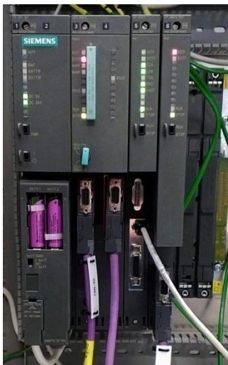
KUVA 23. Siemens S7-400 -sarjan ohjelmoitava logiikka moduuleineen
