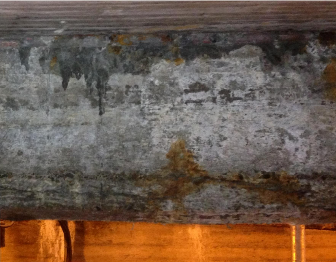
KUVA 3. Palkki 6. Kalisuoalan purkupaikka, YARA. Kriittisen kloridipitoisuuden aiheuttama raudituksen korrosio
