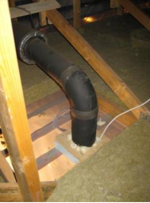
KUVA 1. Ilmanvaihtokanavan läpivienti (Ilmatiiivis rakentaminen. 2009)
