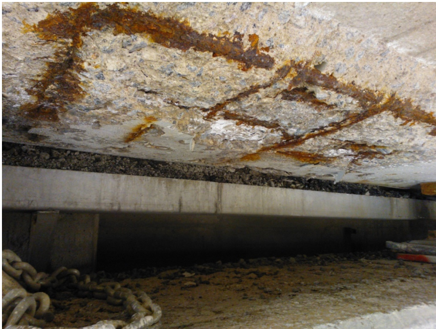
KUVA 7: Vaurioita laattasillan päällysrakenteessa
