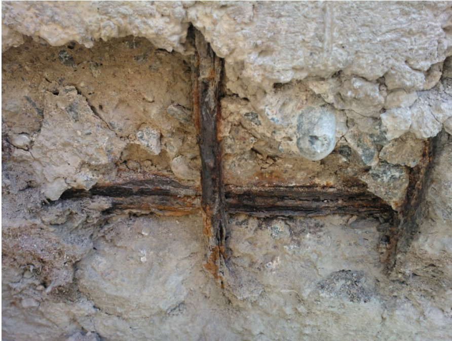
KUVA 8: Paikallinen vaurio kotelopalkkisillan päällysrakenteessa
