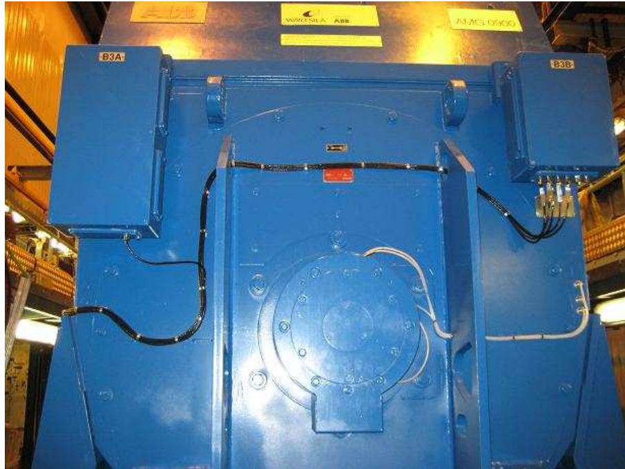
Kuva 15. Keskuksille menevät kaapelit niputettuna.
