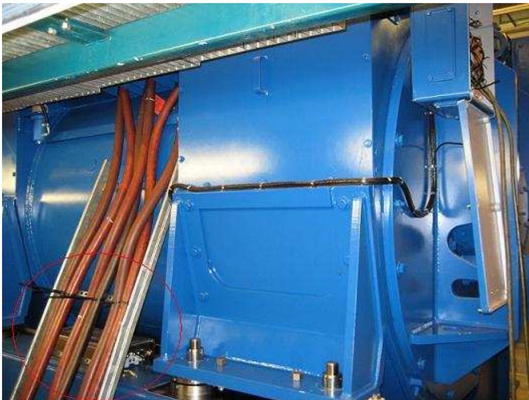
Kuva 15. Koeajossa kaapelihylly menee moduulin päältä
