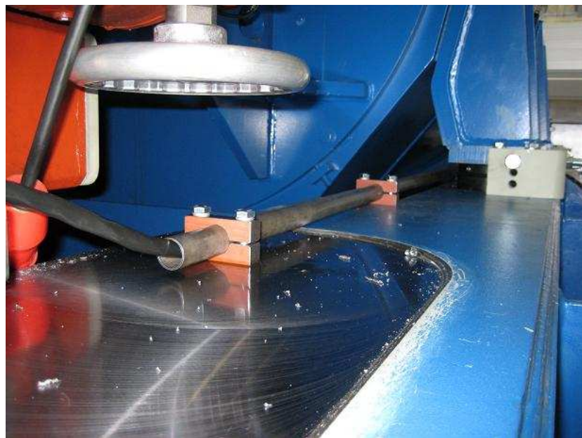
Kuva 4. Väyläkaapeli suojaputkeen laitettuna moottorialustalle.
