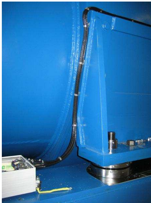
Kuva 10. Moduulilta lähtevät kaapelit niputettuna generaattoriin.
