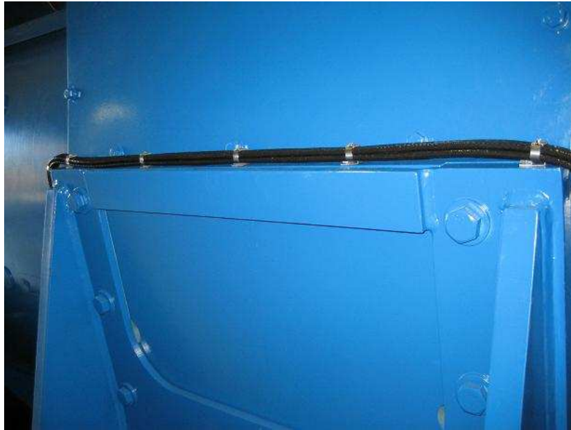
Kuva 11. Moduulilta lähtevät kaapelit niputettuna generaattoriin.
