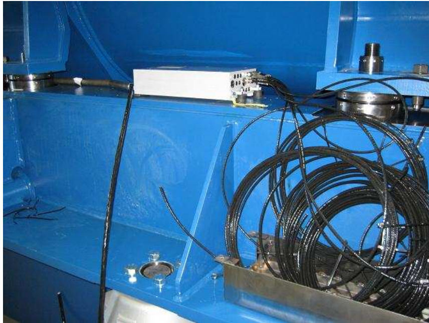
Kuva 9. Moduulin kaapeleiden sijoittelu.
