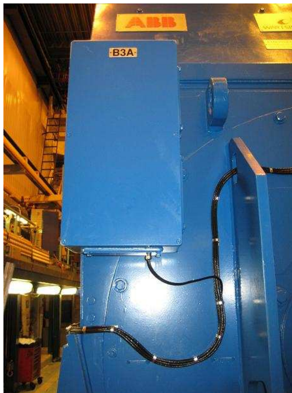
Kuva 14. B3A- ja B3B keskuksille menevät kaapelit kiinnitettynä teräsiteillä.
