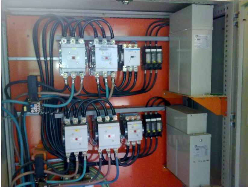
KUVA 8. Kondensaattorit ovat kytketty moottorien käynnistimien liittimiin
