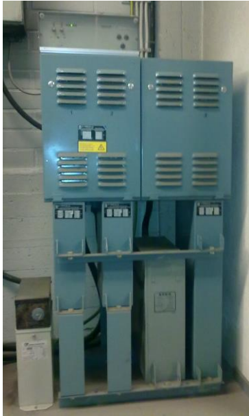
KUVA 22. PK 2:n kondensaattoriparistot
