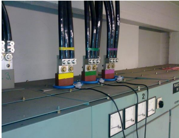
KUVA 21. Virranmittaus muuntajalta T1 tulevista nousukaapeleista
