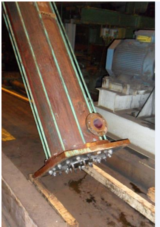
Kuva 2. Lämmönsiirtimen alapää kaatotilanteessa
