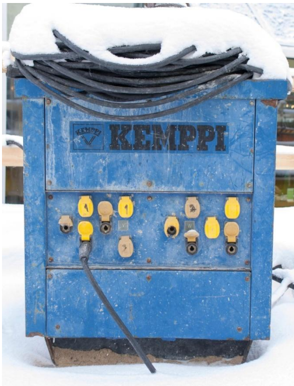
Kuva 19. Työmaalla lankalämmitykseen käytetty muuntaja. (Kuva: Juha Uusitalo)
