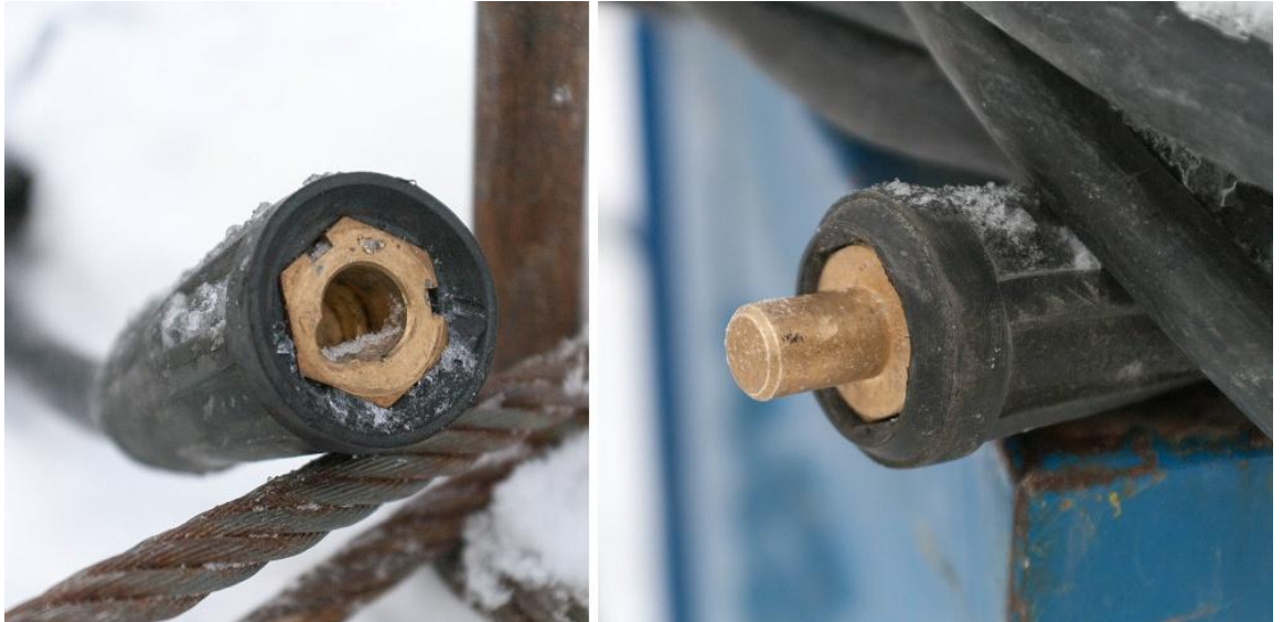
Kuva 21. Runkokaapelien naaras- ja urosliittimet. (Kuva: Juha Uusitalo)
