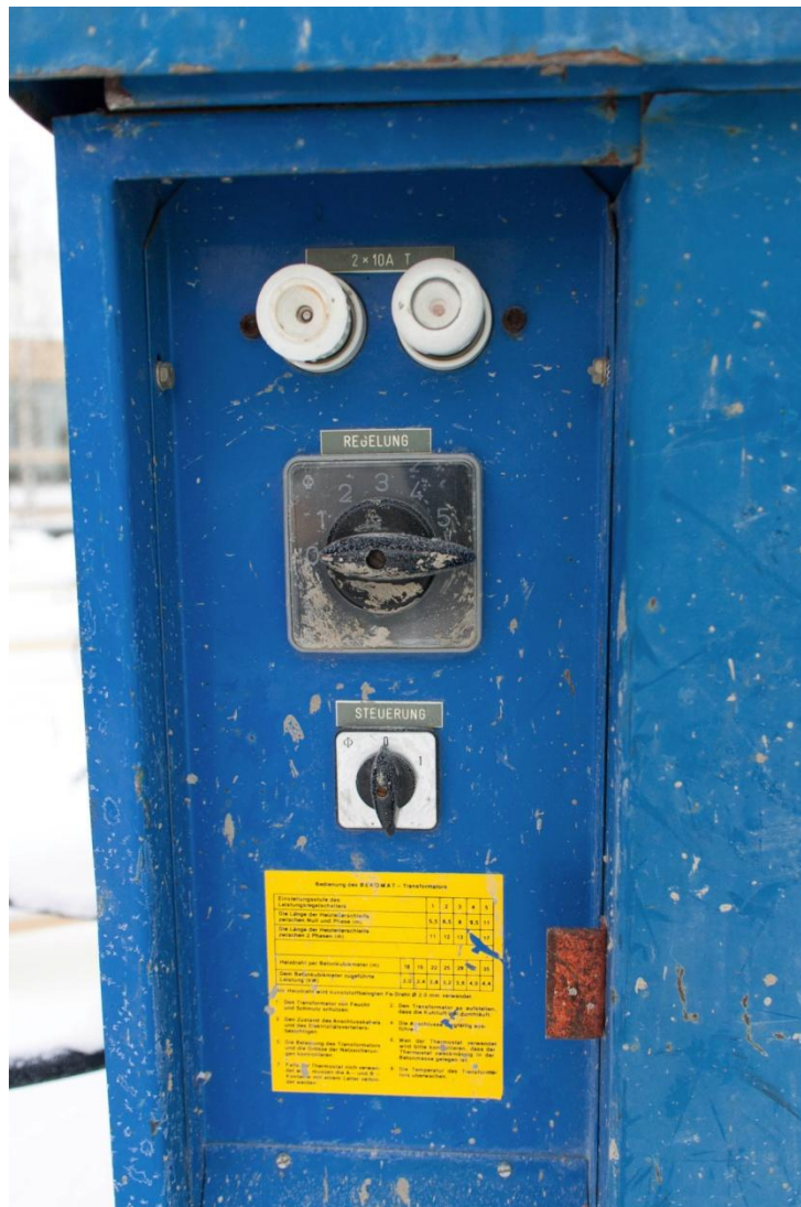
Kuva 24. Lankalämmitysmuuntajan tehonsäätö. (Kuva: Juha Uusitalo)
