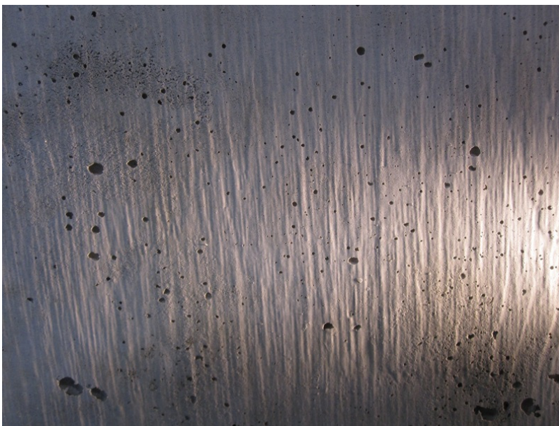
Kuva 29. Betonipinta keinovanhentamattomasta muottimateriaalista 6.
