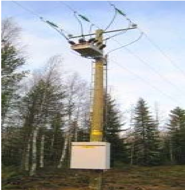
KUVA 5, Netcontrolin valmistama NetRecloser pylväskatkaisija ja ohjauksyksikkö
