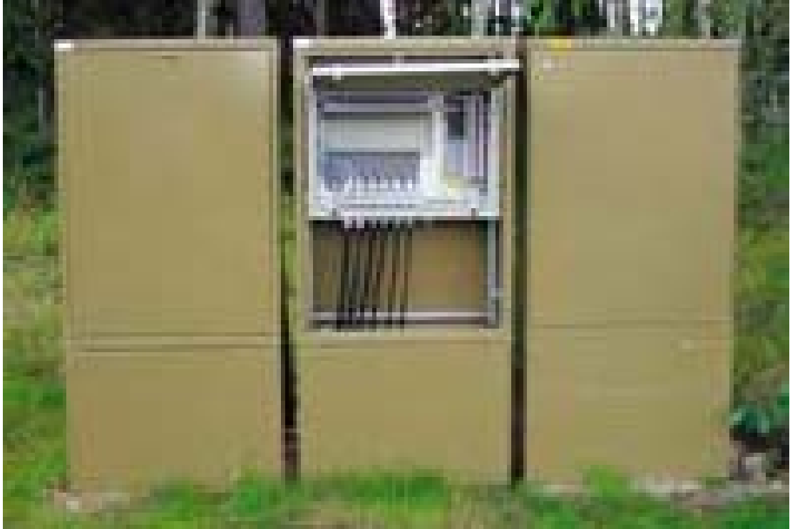
KUVA 13. Valokuitukaapelien jatkos- ja ristikytöntäkaappi ( Draka 2013).
