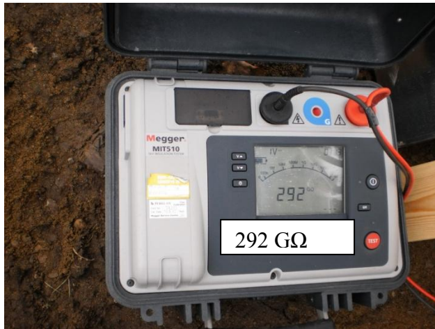
KUVA 11. Eristysresistanssin mittaustulos vaiheiden väliltä
