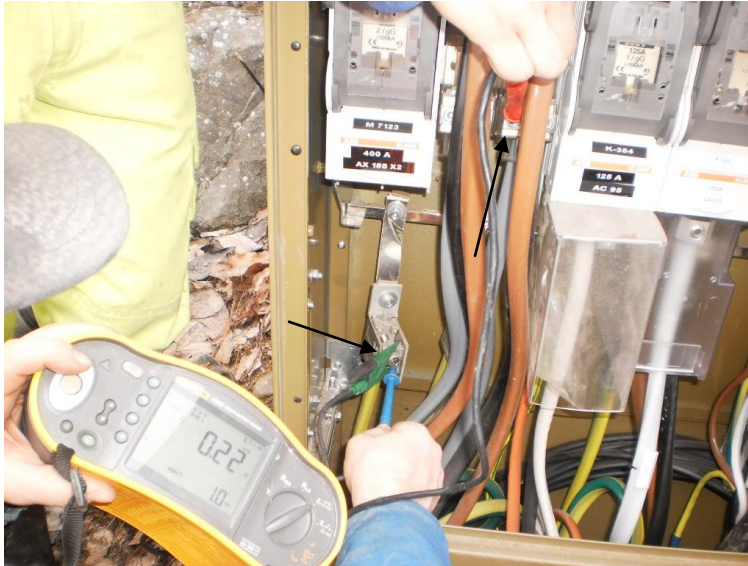
KUVA 13. Oikosulkuvirran mittaus jakokaapilla
