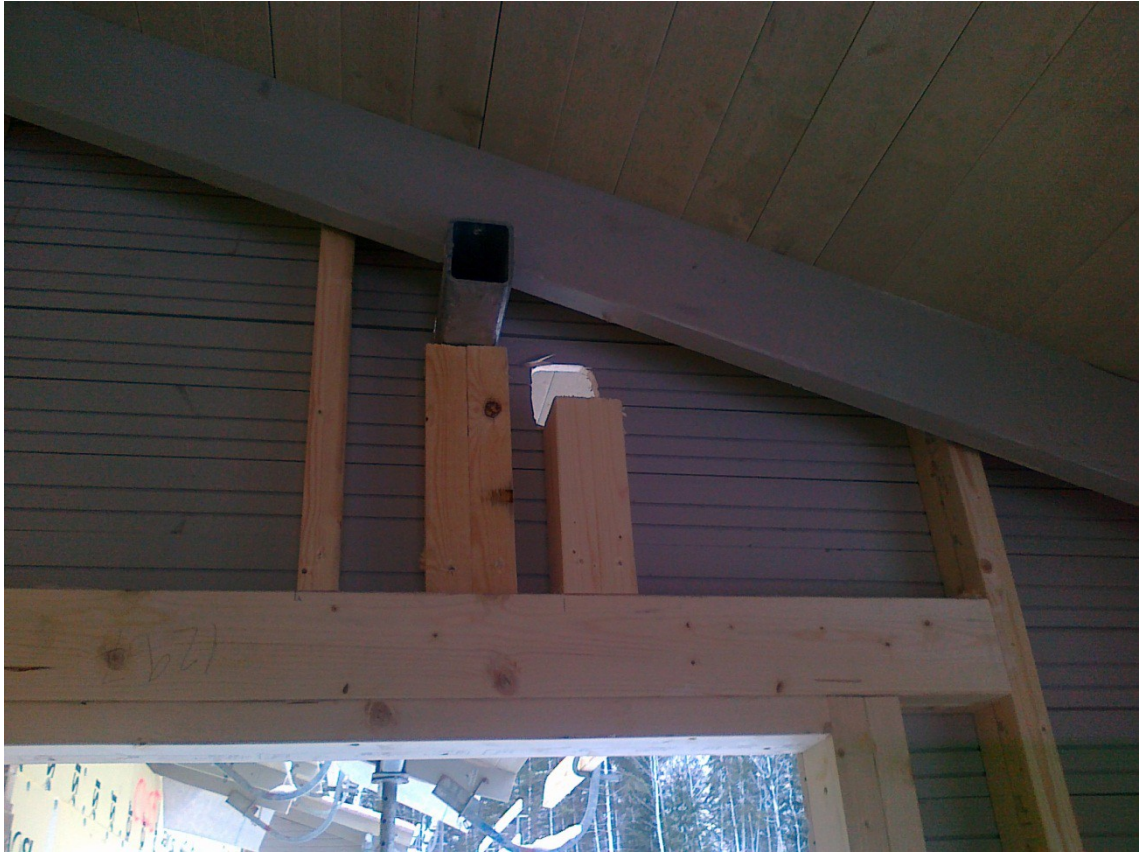
Kuva . Mitoitusvirhe elementtirakentamisessa.
