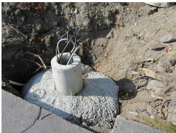
Figur 20. Ett bergsfundament gjöts över med betong. Man bör beakta att kablar inte får gutas fast utan att de skyddas i rör.
