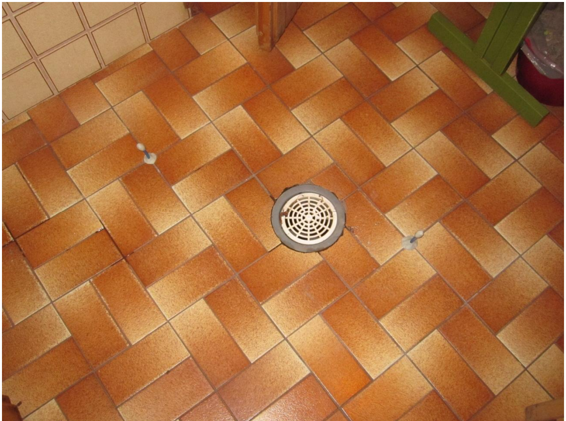
Kuva 1. Mittauspisteet lattiakaivon ympärillä.
