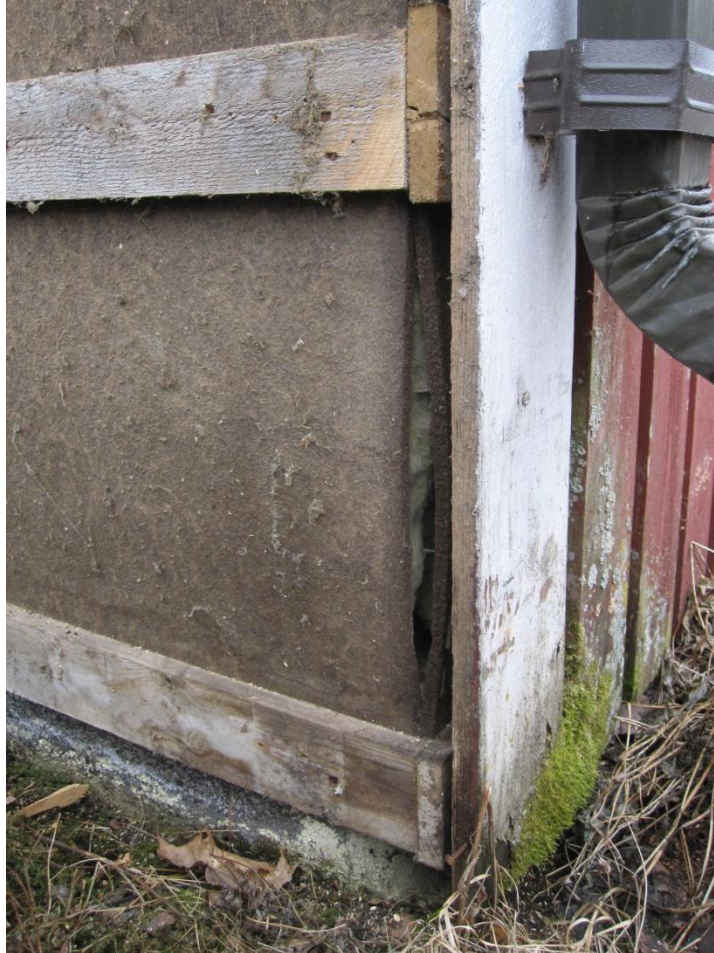
Kuva 4. Lämpökamerakuvauksessa havaitun ilmavuodon syy.
