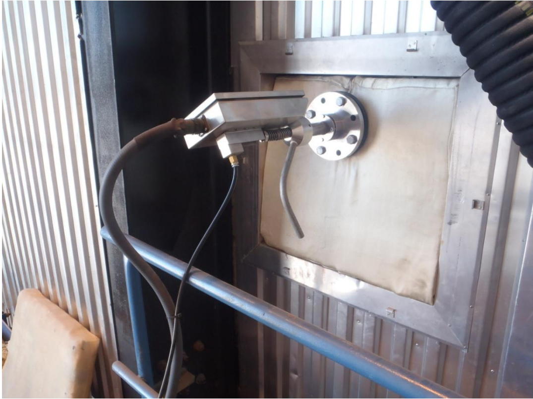
Kuva 18. MoCo DP -anturi asennettuna
