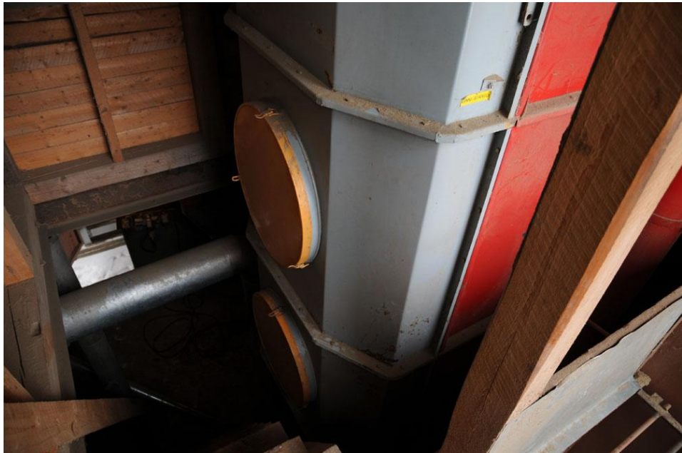
Kuva 5. Kuivurin poistoilmapuolen huoltoluukut.
