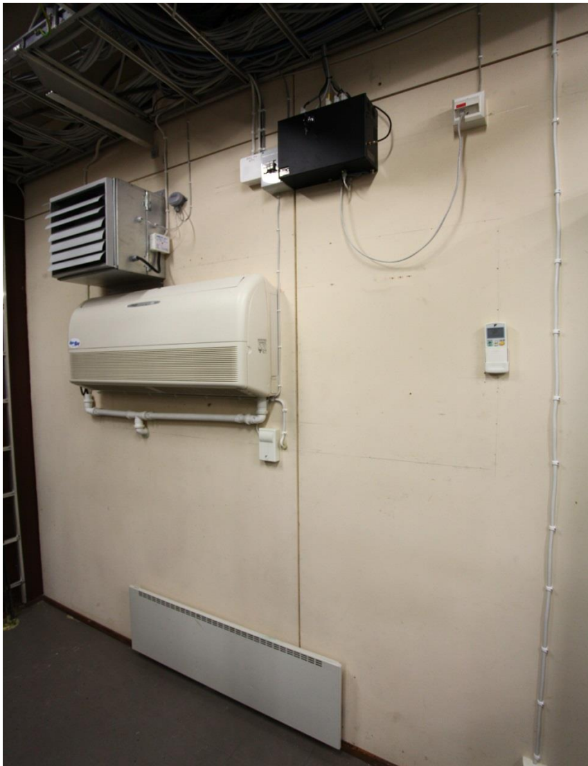
Kuva 3. Laittilan jäähdytysjärjestelmä kylmäkoneen ja tuloilma-aukon kanssa.
