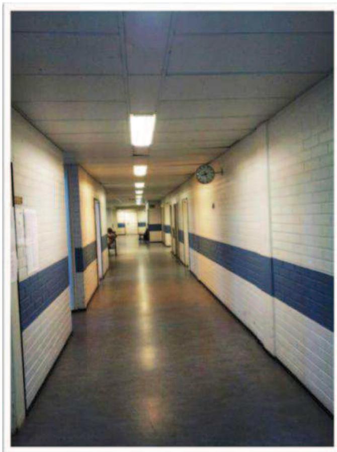
Kuva 5. Perinteinen loisteputkilla toteutettu käytävävalaistus
