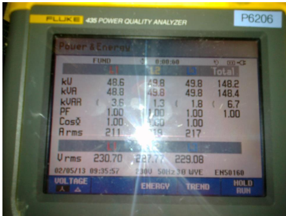
Kuva 17. Sähkötehon kulutus hetkellisesti
