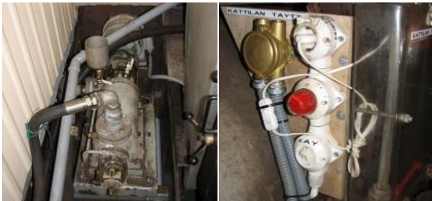
KUVA 1. Sähköisen syöttövesipumppu ja käynnistyskytkin
