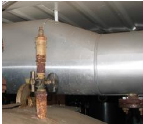
KUVA 6. Tyhjä- ja ilmausventtiili
