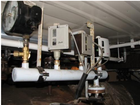
KUVA 10. Kattilan painekatkaisimet ja painemittari.
