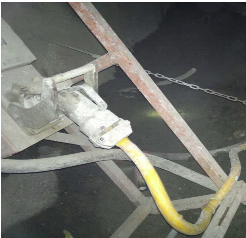
Kuva 10. Ruiskurobotin häntäkaapeli ja hanska asiaankuuluvasti kytkettynä VYK-sähkökeskukseen. Taustalla näkyy vedonpoiston kiinnitys seinäkoukkuun.
