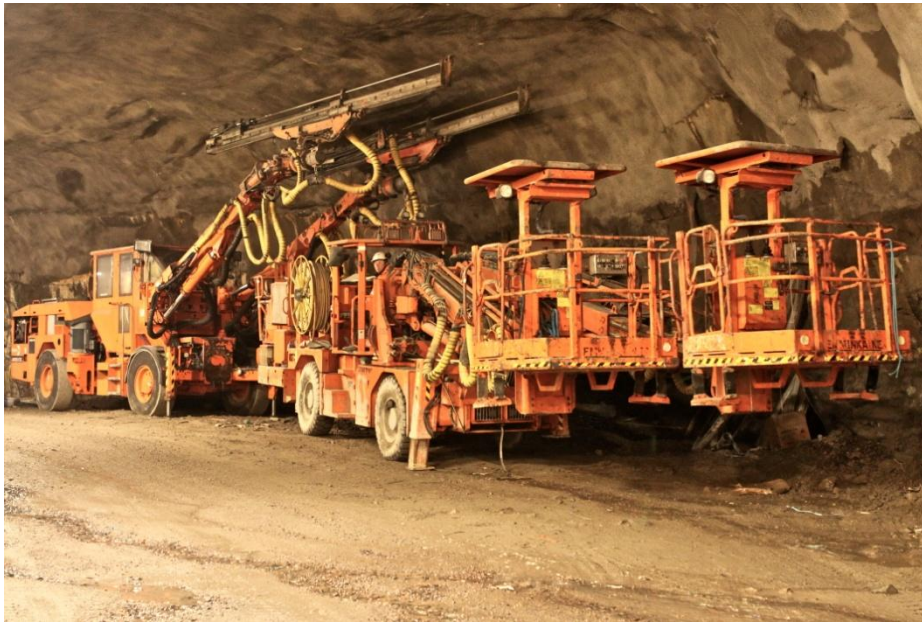
Kuva 2. Kuvassa etualalla panostuksessa ja rusnauksessa käytettävä henkilönostin varustettuna komukatoksia Ruoholahden työmaalta. Taka-alalla porajumbo. Kuva: Timo Kotineva
