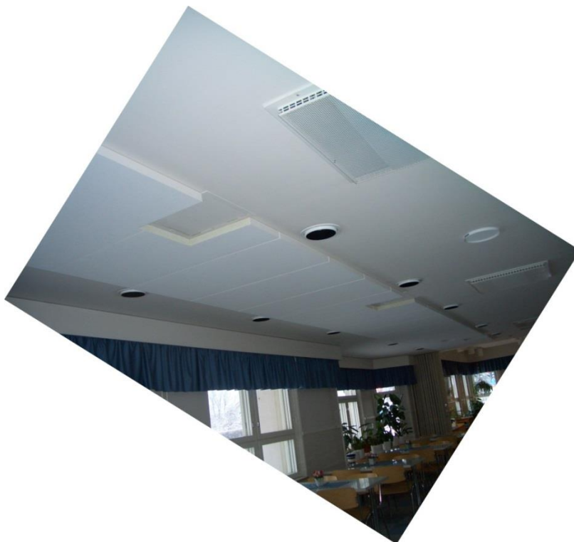
Kuva 9. Akustiikkalevyt ruokasalin katossa vähentävät melua ja parantavat kuuluvuutta. (Kuva: Linda Nevalainen.)
