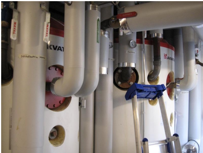
Kuvio 5. Rakennuksen vesivaraajat.
