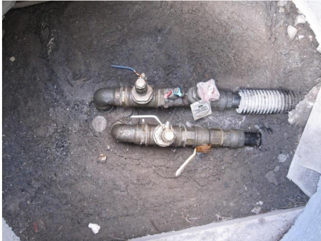
Kuvio 2. Lämpökaivon putket.
