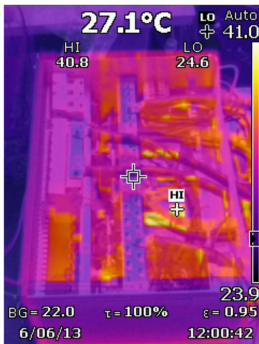
Kuva 9. Lämpökamerakuva tehonsyöttöjärjestelmästä: vasemmassa reunassa näkyy jakelu- ja akkusulakkeet ja jakelusulakkeiden reuna hohtaa oranssina.
