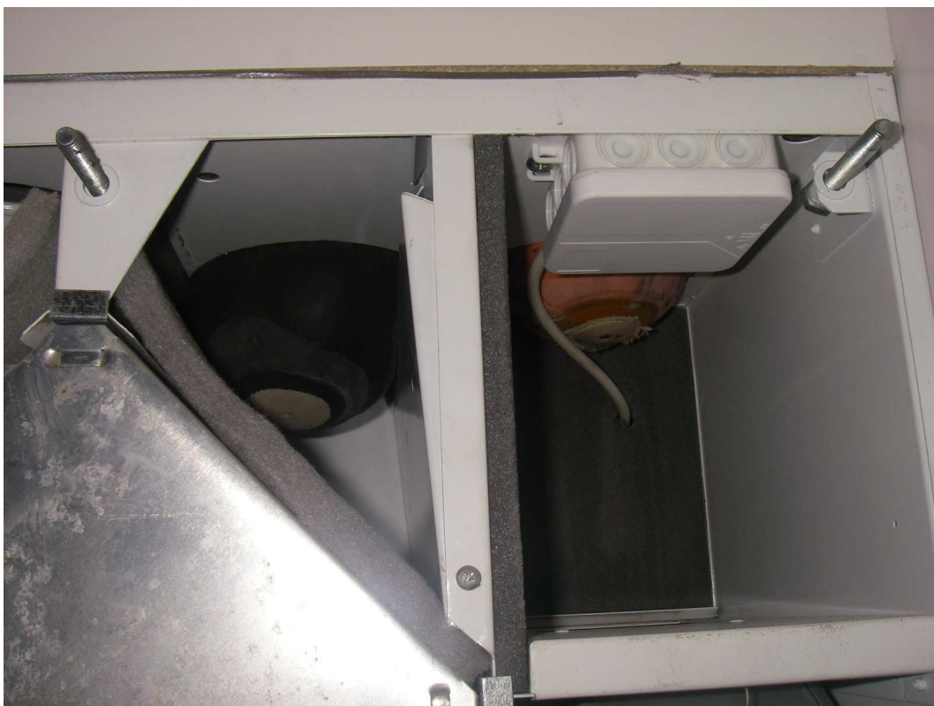
Kuva 9. Ilmanvaihtokoneen tulo- ja poistoilmakanava tukittuna ”ilmapalloilla”.
