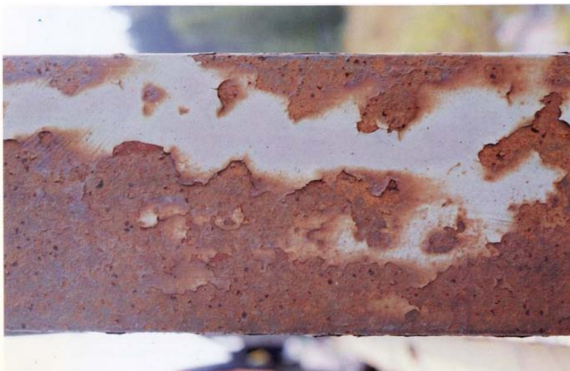
KUVA 1. Korroosiotuotteena syntynyttä ruostetta (SILKO 1986.)
