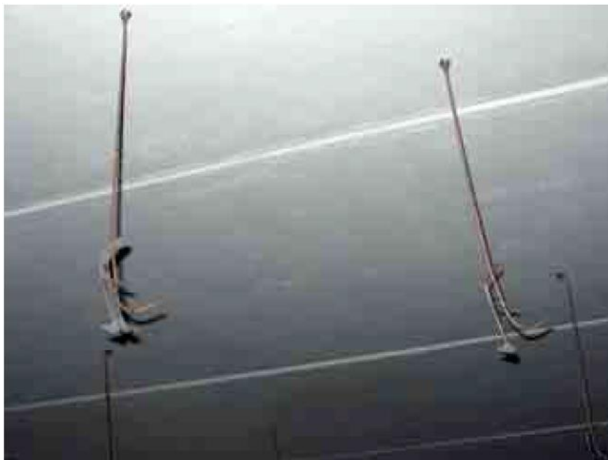
KUVA 6. Kylpylän alakaton romahtaminen Kuopiossa (Kuva: Onnettomuustutkintakeskus)
