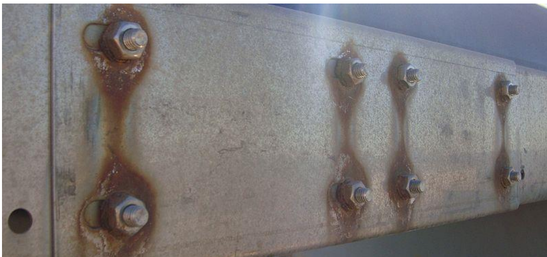
KUVA 5. Jalusero pulttien ja levyn välillä aiheuttaa galvaanista korroosiota (Kuva: Wikipedia)
