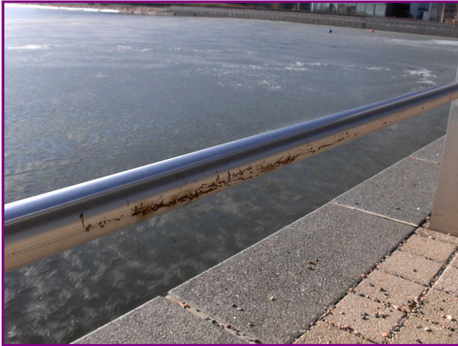
KUVA 2. Pistekorrosio ruostumattomassa teräksessä (Ruostumattomien teräsrakenteiden paikallisen korroosion riskin arviointi 2008, 6.)
