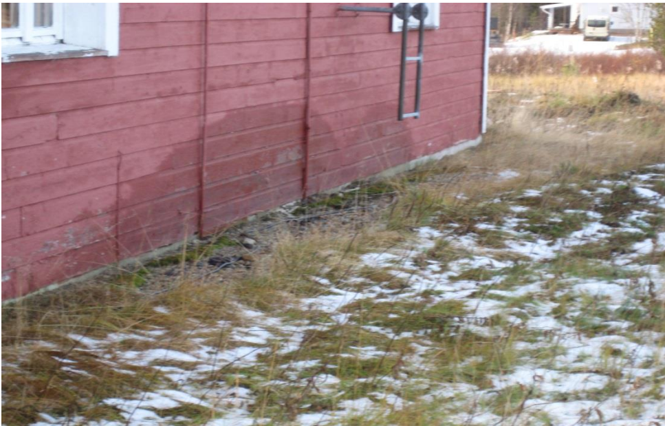
KUVA 3. Maanpinnan taso ja muotoilu homevaurioita kärsineen hirsikehikon kohdalla.
