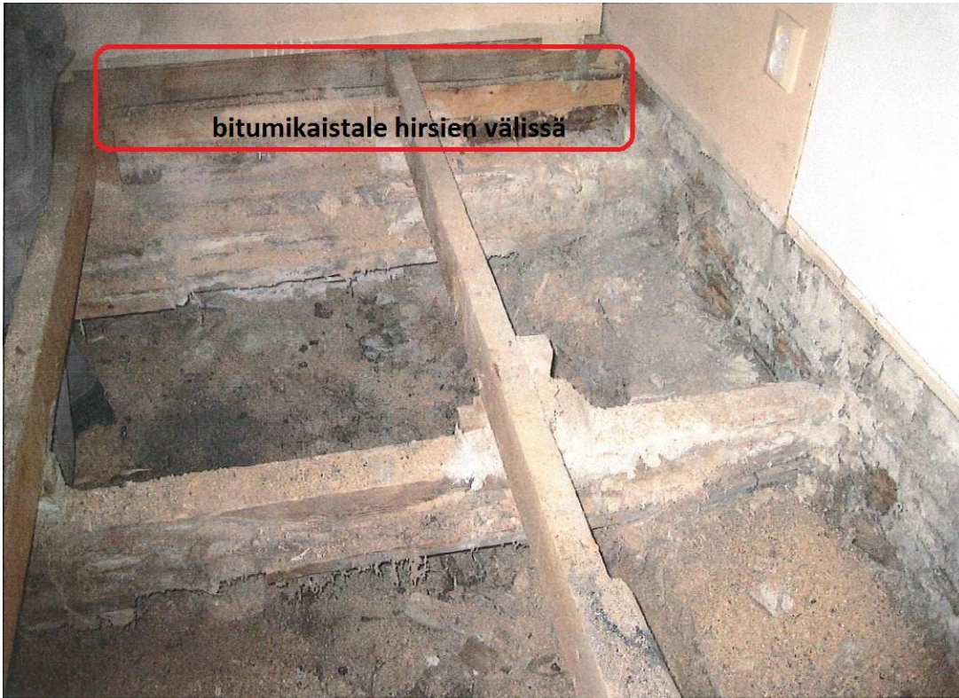
KUVA 2. Hirsirungon ulkokehän homevaurio / Bitumikaistale hirsien välissä.
