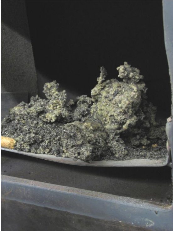
Kuva 18 Kattilan suuaukolle kertynyt klinkkerimuodostuma
