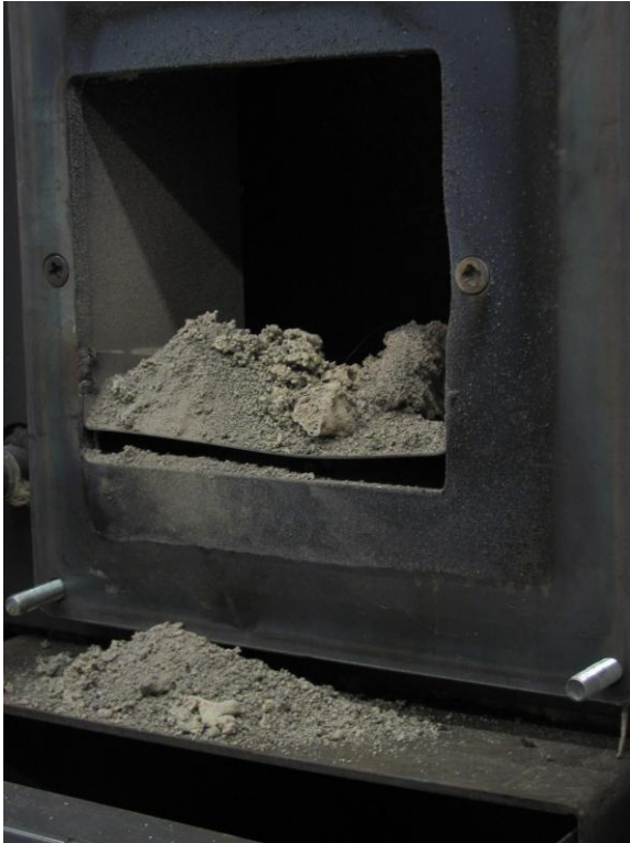
KUVA 30. Polttimen ja kattilan yhtymäkohtaan kertynyt klinkkeri ja tuhka
