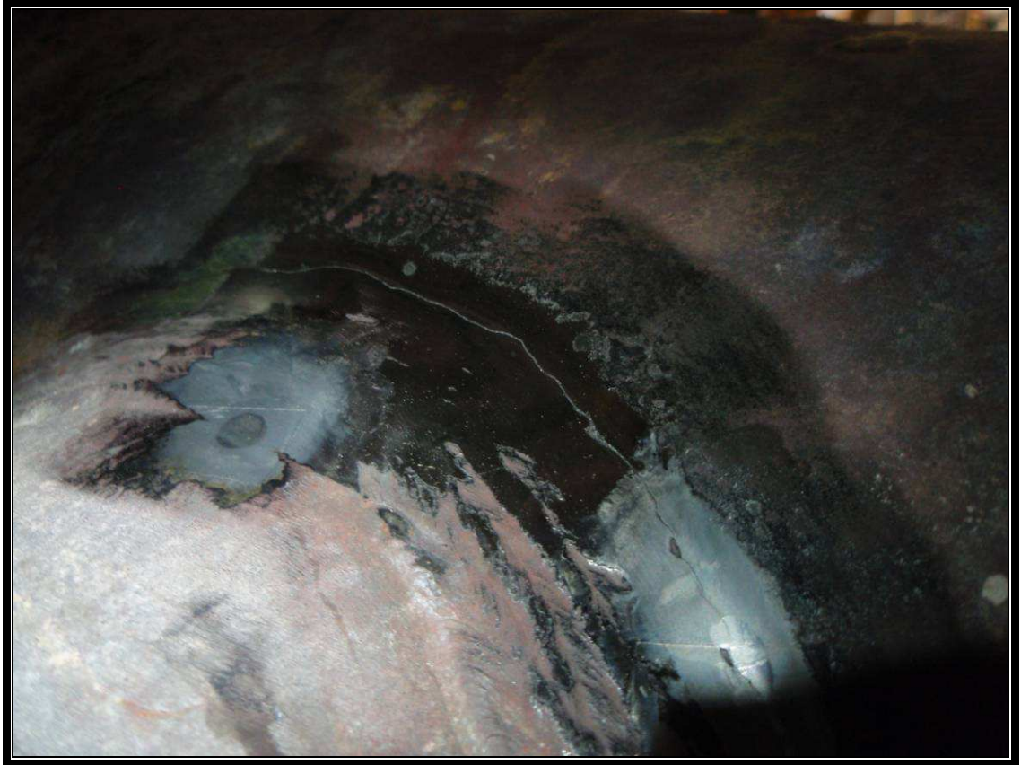
Kuvio 18. Jäljenteiden otto pähöyryputken ja venttiilin liitossaumasta.. Virumavaurio on edennyt säröytymiseen asti. (Inspecta Oy).
