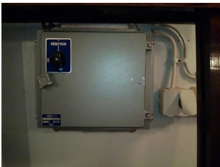
KUVA 6. Väestönsuojan jakokeskus, VSSK (Valokuva Sami Linnoaho)
