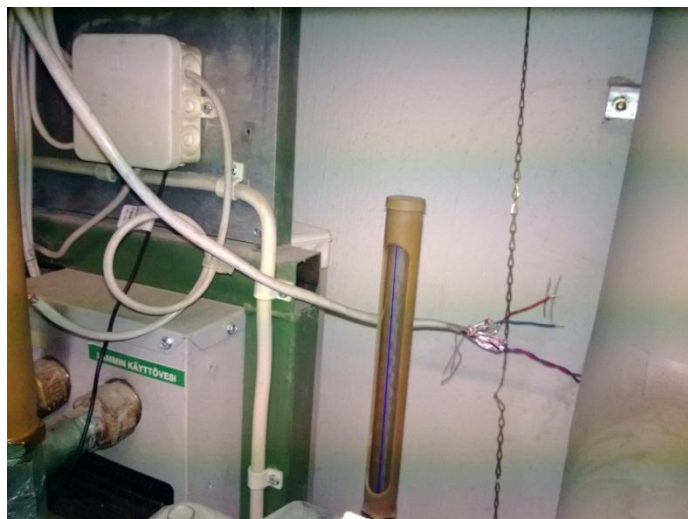
KUVA 15. Kaukolämpöhuoneen irrallinen johdin (Valokuva Sami Linnoaho)
