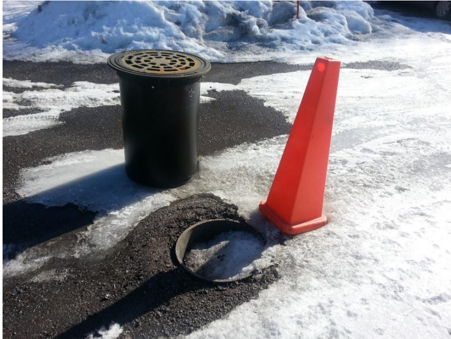
Kuva 41. Pettänyt kaivonkansi aiheuttaa vaaratilanteen parkkipaikalla. Uusi kansi ja säätöputki odottavat asennusta. Kuva: M. Saarikangas.
