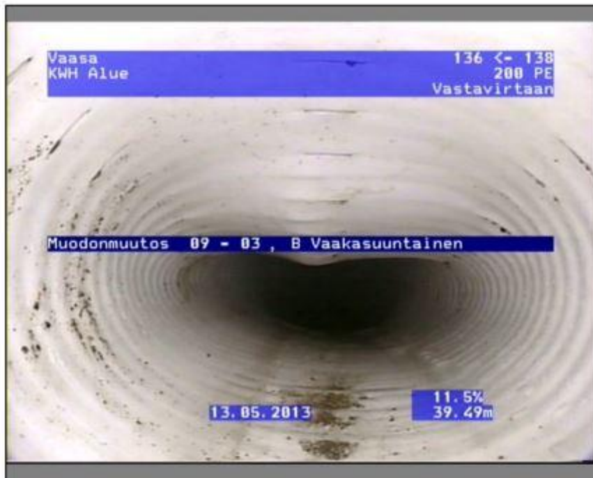
Kuva: KWH Sadevesilinjat_1381360942304_A.JPG 39,49m, Muodonmuutos 09 - 03 , B Vaakasuuntainen
