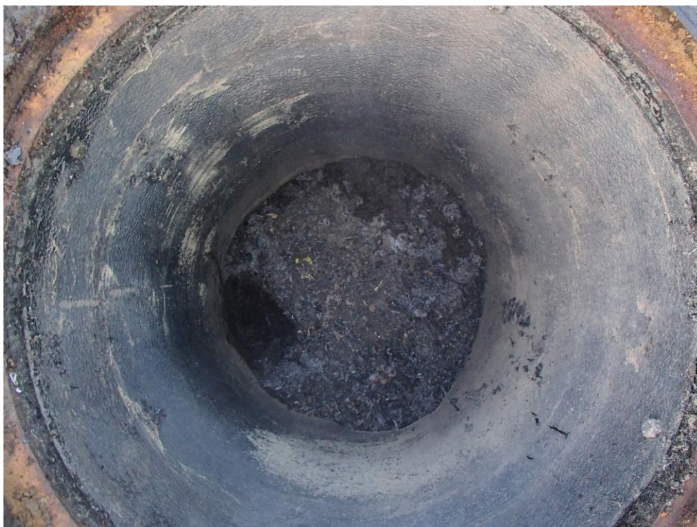
Kuva 23. Muovijätteestä tukkeutunut kaivo. Kuva: M. Saarikangas.
