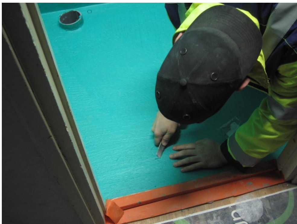
Kuvio 12 Työjohtaja ottamassa vedeneristysnäytettä kylpyhuoneen lattiasta. As Oy Satakallio vaihe 3:n työmaalta.
