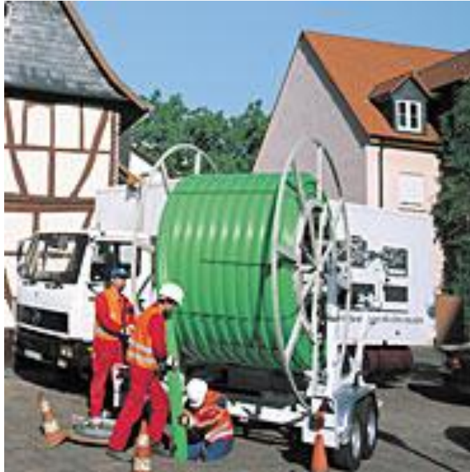
Kuvio 2 Omega-putken asennus vanhaan pohjaviemäriin käynnissä. NRG Nordic Renovation Group Oy:n kotisivuilta.
