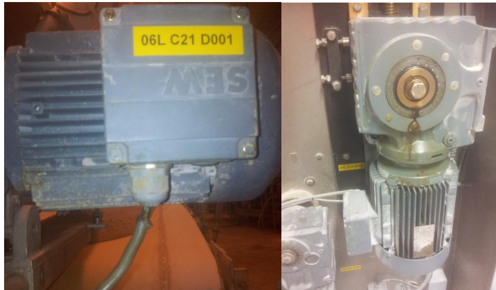
KUVA 6. Moottorin kaapelin vedonpoisto pettänyt (vas.) ja moottorin vaihteen tiiviste vuotaa öljyä (oik.)
