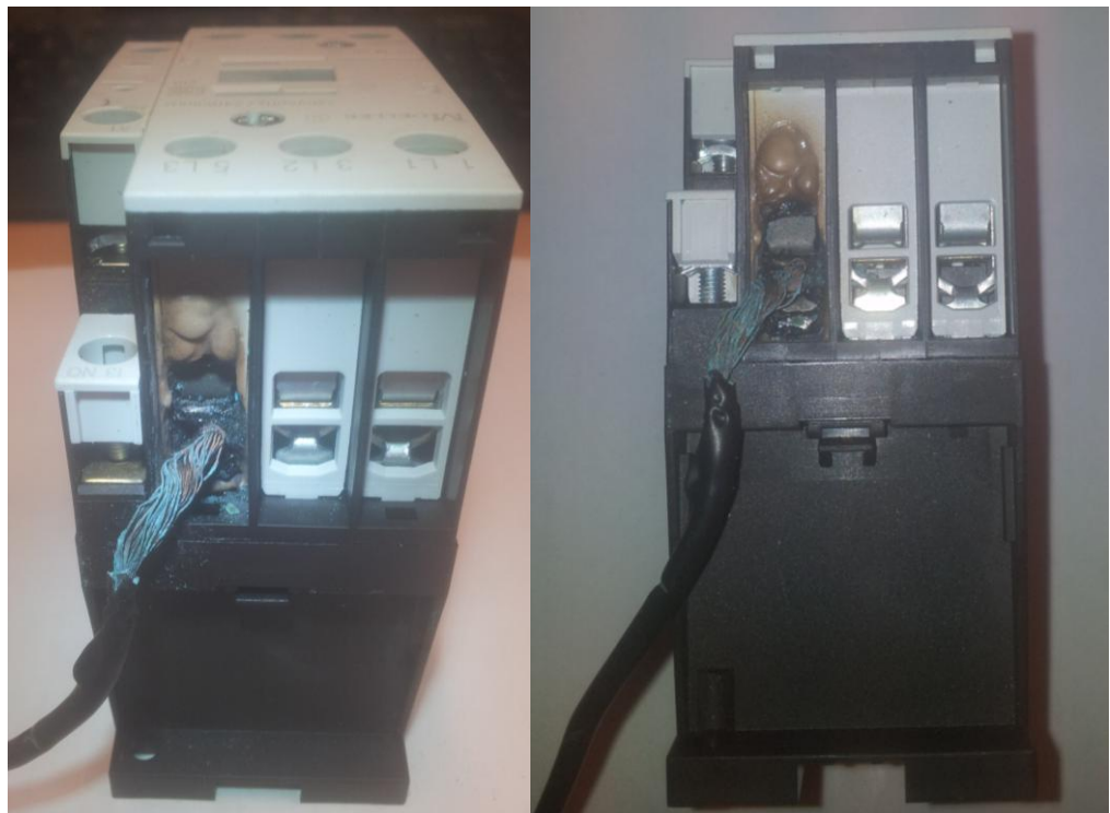
KUVA 3. Moottorilähtö kuudennen linjaston sähkökeskuksessa
