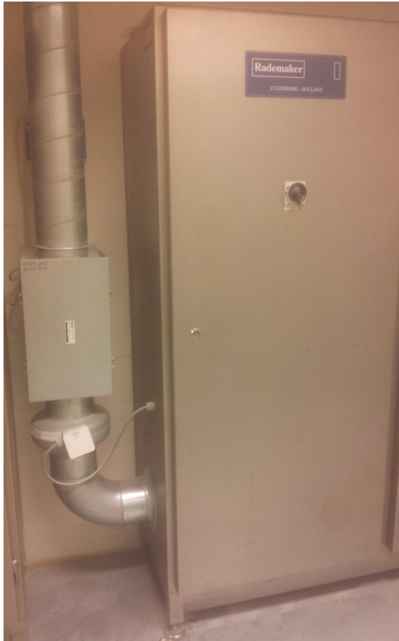
KUVA 4. Sähkökeskus ilmanvaihdolla ja suodattimella
