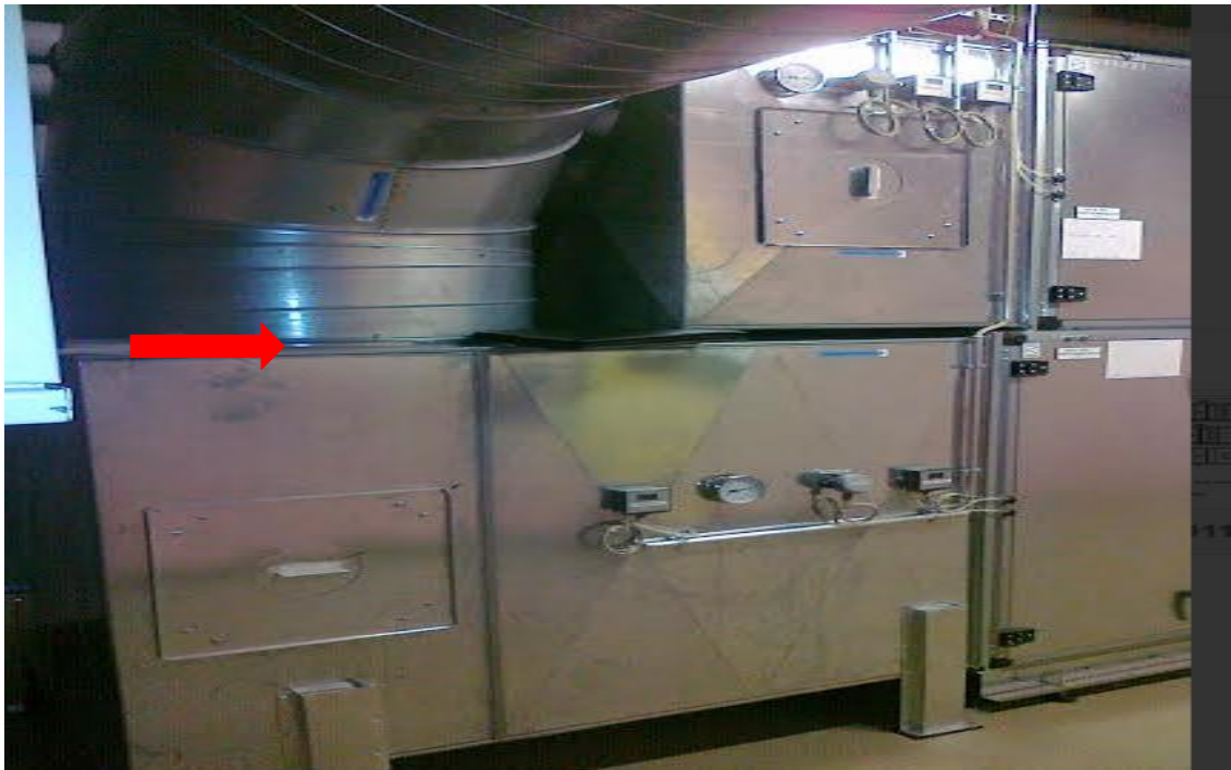
Kuva 8. Poistoilmakanaviston yhdistyminen poistoilmakoneeseen. Yhdistymiskohta on merkitty punaisella nuolella.
