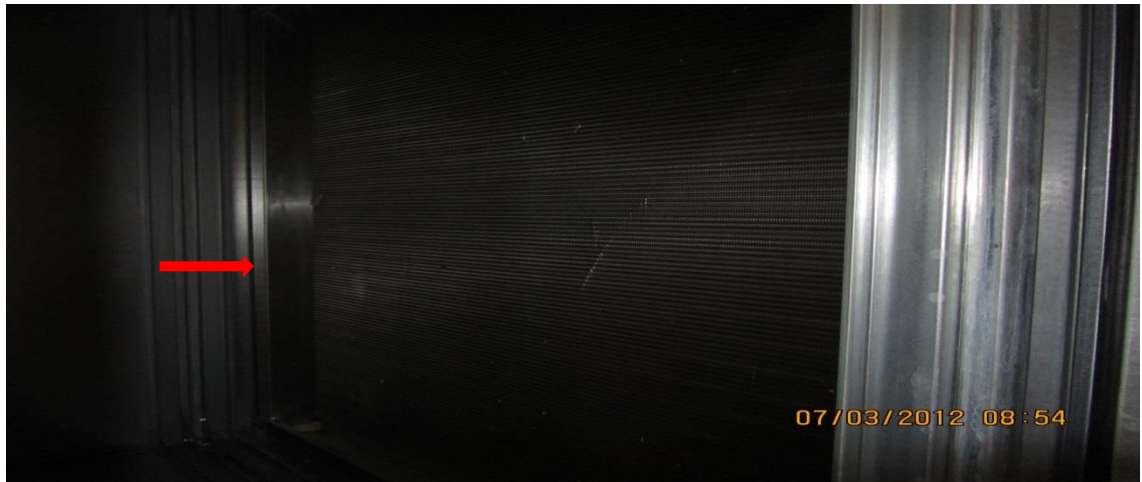
Kuva 14. Lamellipatteri. Punaisen nuolen osoittamaan suuntaan siirtyy poistoilmavirta lamellipatterin läpi.
