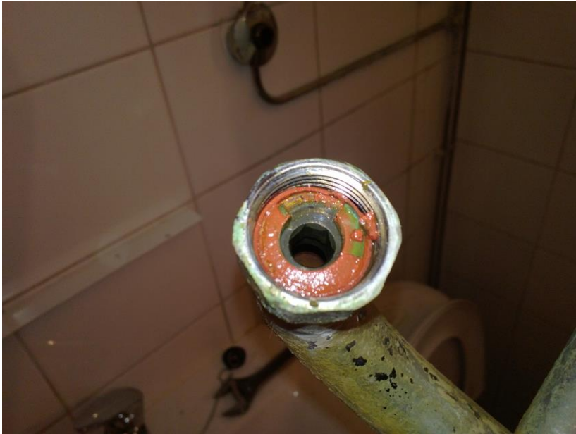
Kuva 9. Pyyhekuivaimen vuodon aiheuttanut vaurioitunut tiiviste.
