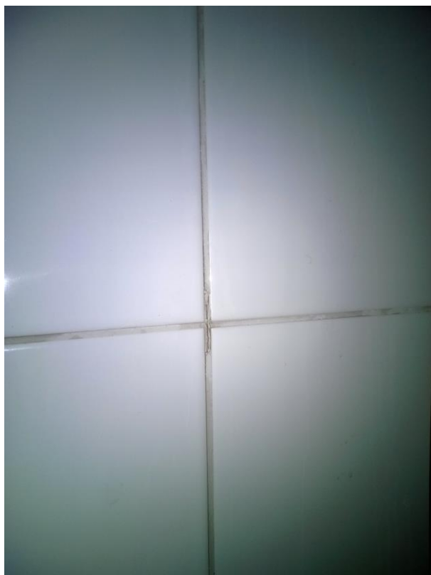
Kuva 11. Laattojen välistä tihkui vettä.
