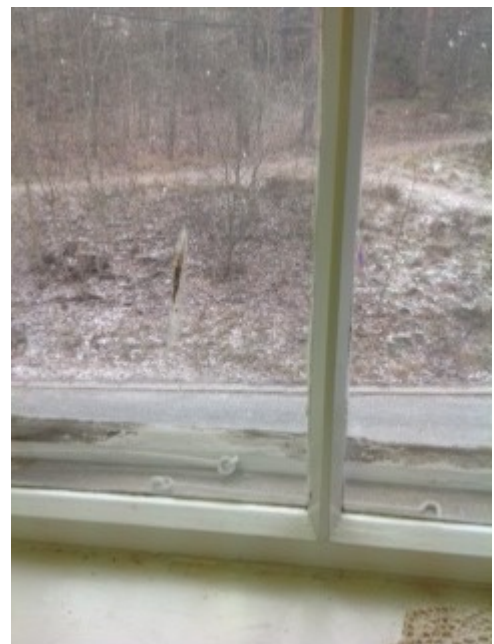
KUVA 2: Ikkunoiden kunto (Kuva: Seija Vaitti 2013)
