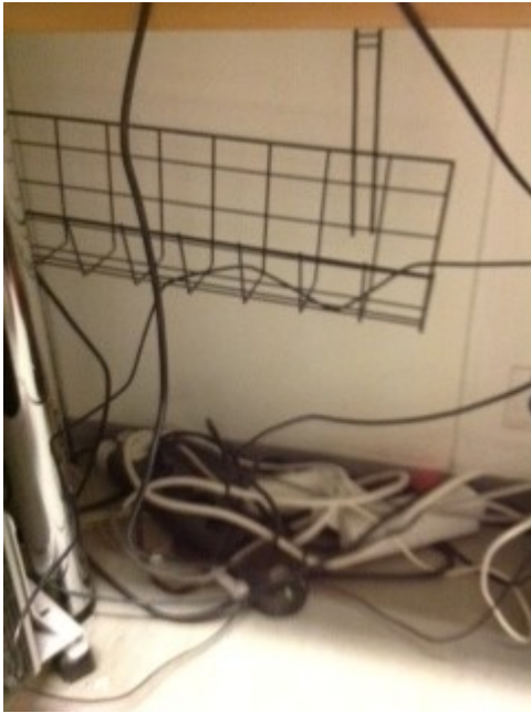
KUVA 3: Vallattomat johdot (Kuva: Seija Vaitti 2013)
