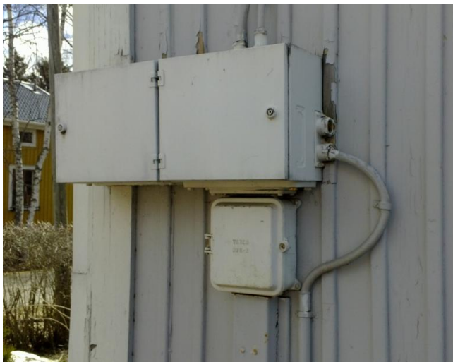
KUVA 26: Sähköpääkeskus (Kuva: Jaakko Huttunen 2012)
