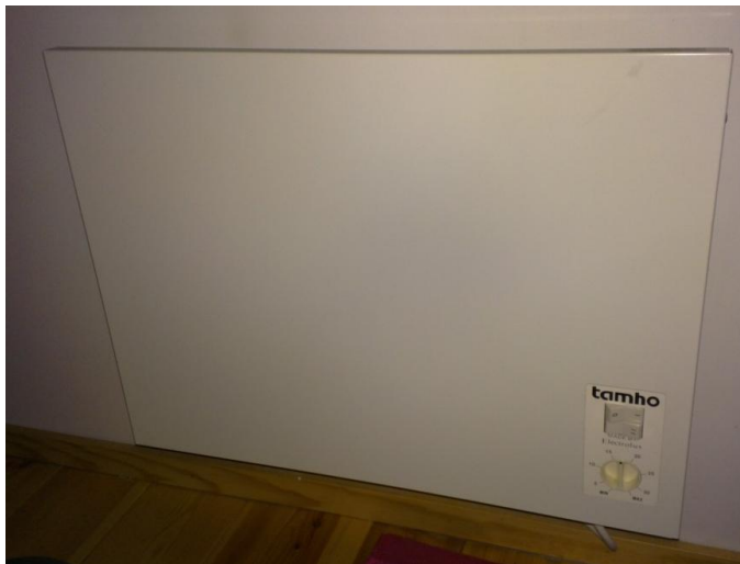
KUVA 21: Makuuhuoneen lämmityspatteri (Kuva: Jaakko Huttunen 2012)
