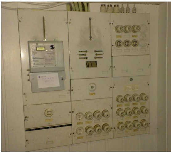
KUVA 25: Kellarin sulaketaulu ja sähköl mittari (Kuva: Jaakko Huttunen 2012)
