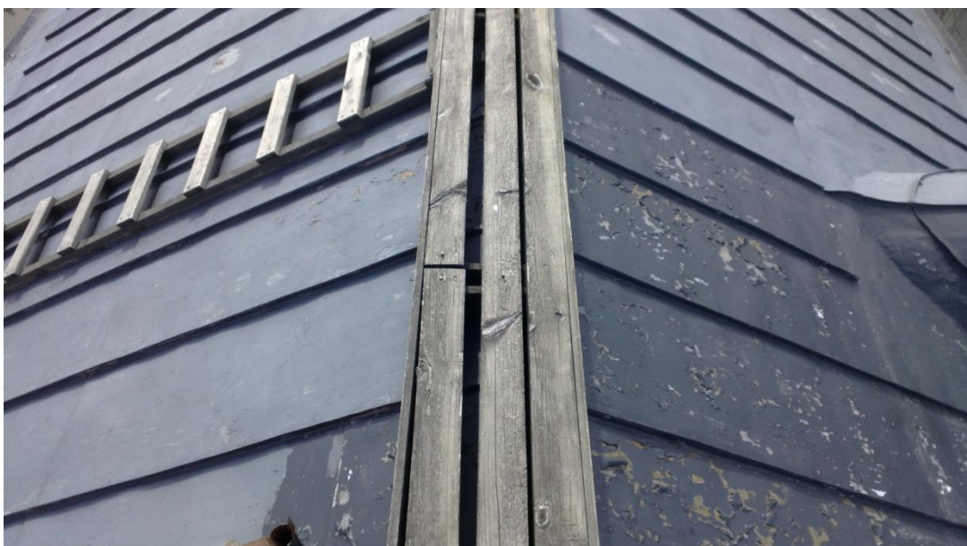
KUVA 9: Kattotikkaat ja huoltosilta (Kuva: Jaakko Huttunen 2012)
