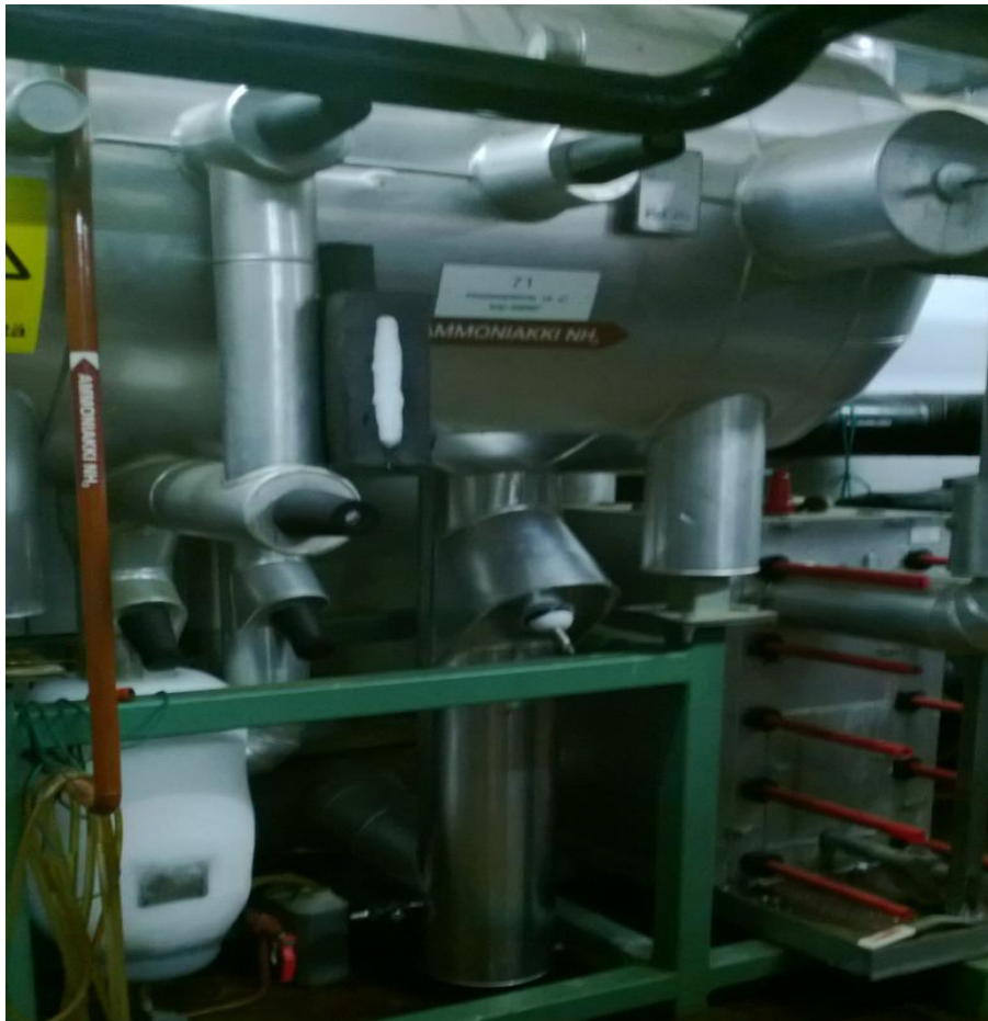
KUVA 5. Jäähallin kylmäprosessin pisaranerotin, nesteputki ja höyrystin
