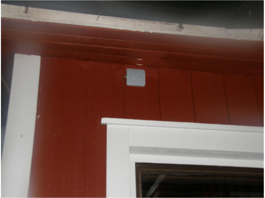
KUVA 3. Huoltorakennuksen ulkoseinälle tuotu antenni
