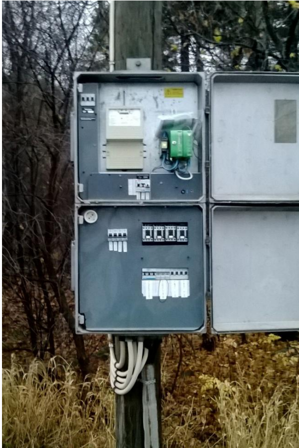
KUVA 1. C2PU, C2CU ja C2RU asennettuna keskukseseen
