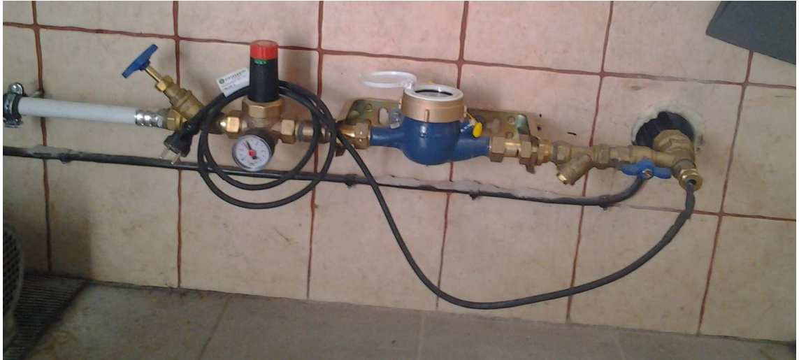
Kuva 7. Kiinteistön uusi vesimittari, vakiopaineventtiili, lianerotin sekä sulku- ja takaiskuventtiilit. Tonttivesijohtoon on asennettu lisäksi itsesäätyvä lämmityskaapeli.
